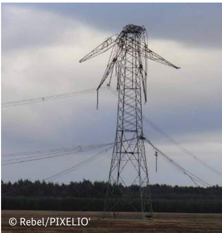
Sturmschaden durch den Orkan Kyrill im Jahr 2007
