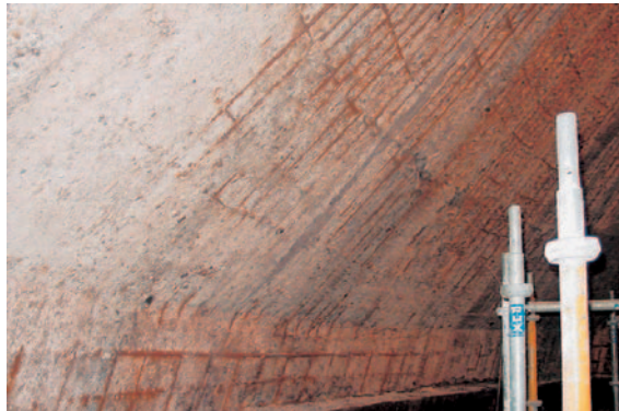
Freiliegende Bewehrung der Dachinnenseite
